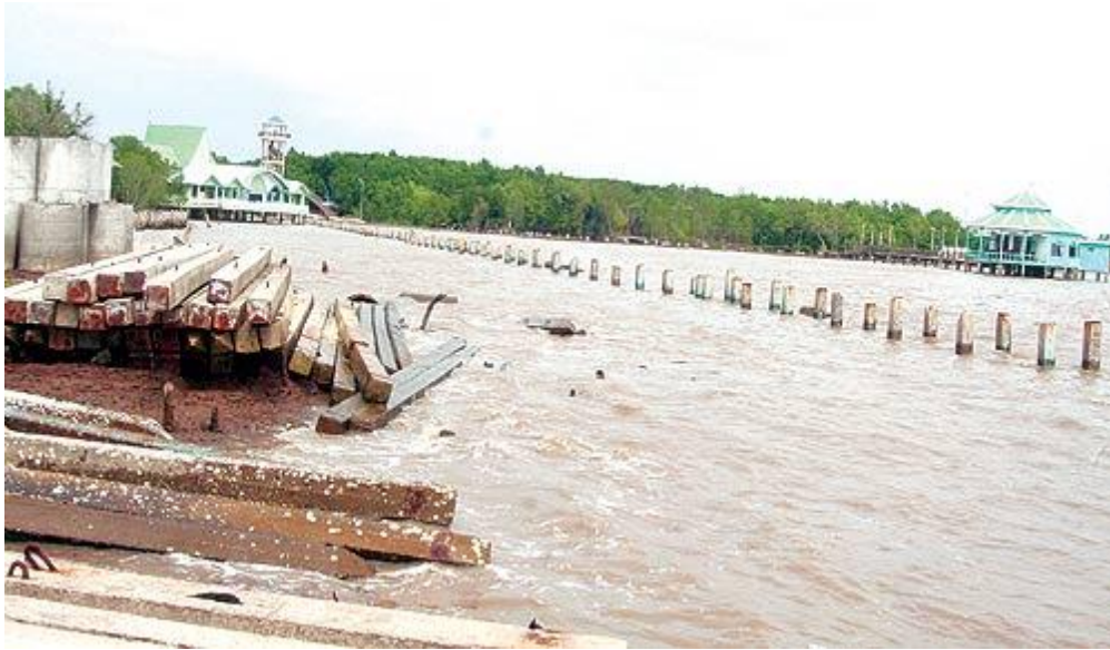
Công trình bờ kè bảo vệ mũi Cà Mau sau nhiều năm triển khai vẫn còn ngổn ngang thế này - ảnh: T.T
