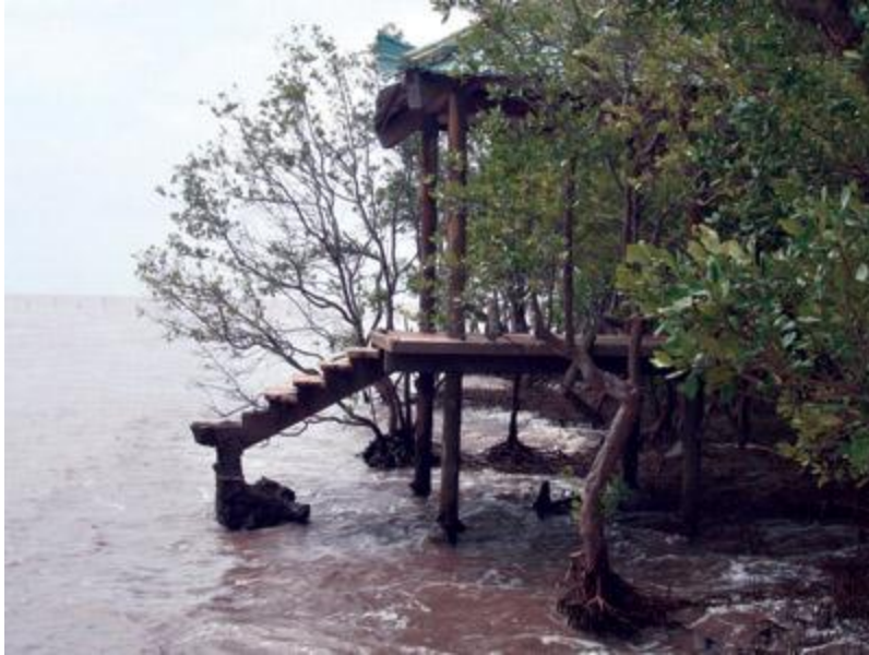
Căn chòi xây phục vụ khách bộ hành tại khu du lịch mũi Cà Mau giờ đã bị biển lấn tới
